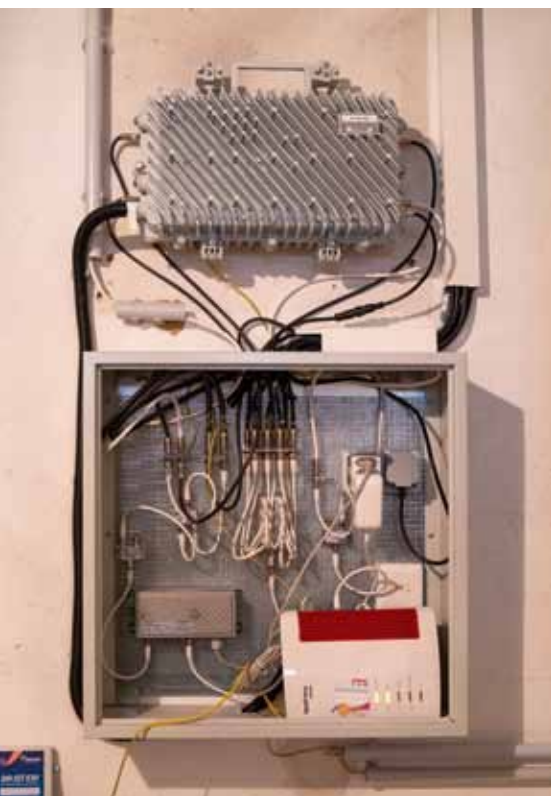
Installierter Remote-CCAP-Node und geöffneter Verteilschrank
